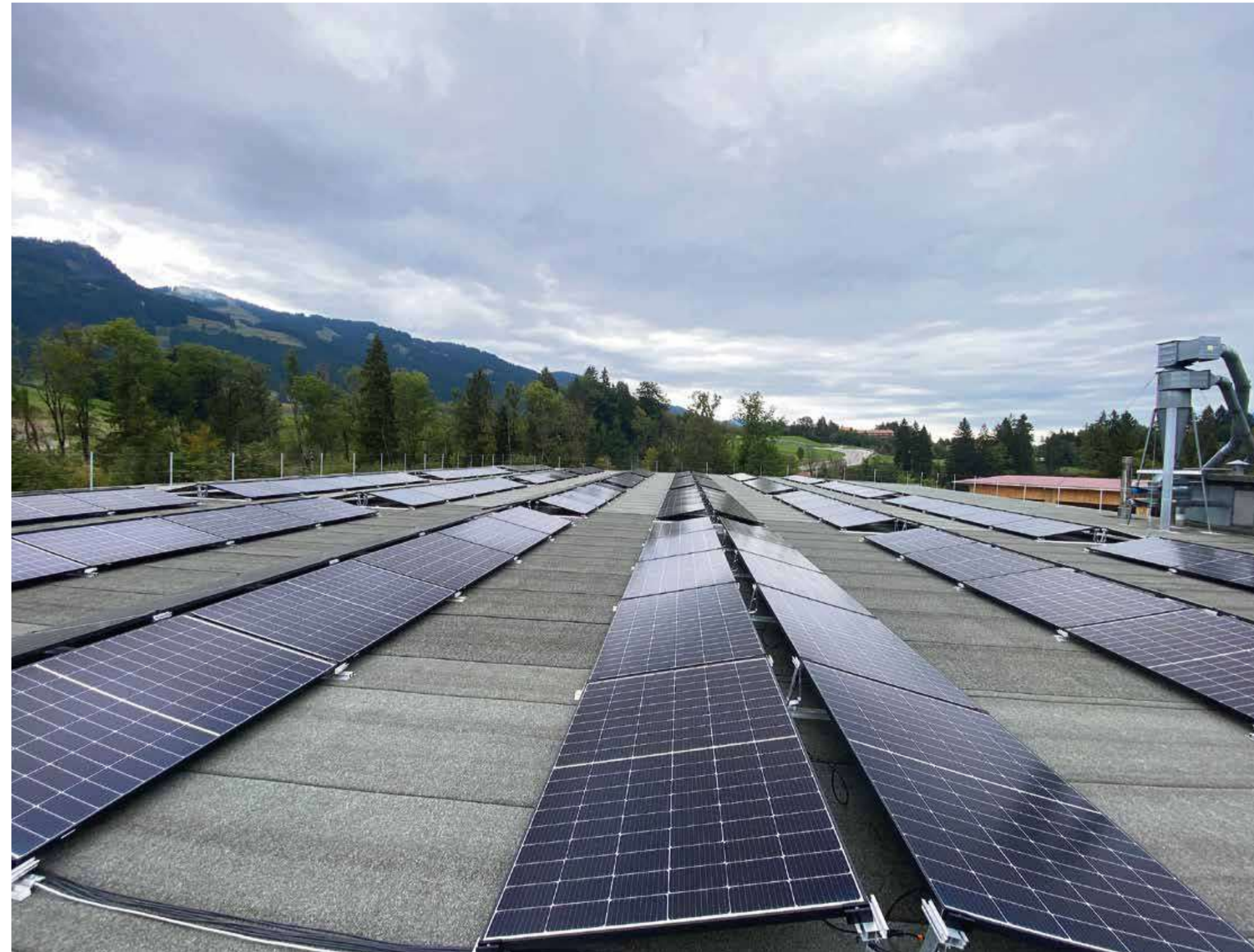
Die Photovoltaikanlage auf dem Dach liefert unter anderem den Strom für die gesamte Lüftungs- und Klimatechnik.
