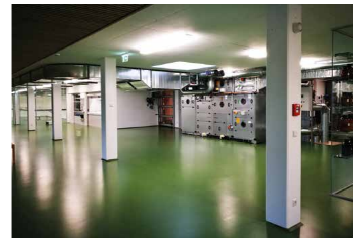
Heizraum und Digitale Ables Haus Schnifis
